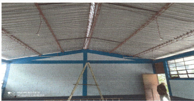
Foto 5: Distribución de cableado eléctrico
